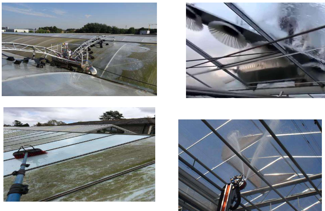
Hình 1.6.43. Sử dụng dụng cụ và máy móc chuyên dụng vệ sinh màng che PE bên ngoài và bên trong nhà màng
