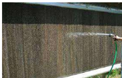
Hình 1.6.50. Vệ sinh tấm cooling pad
