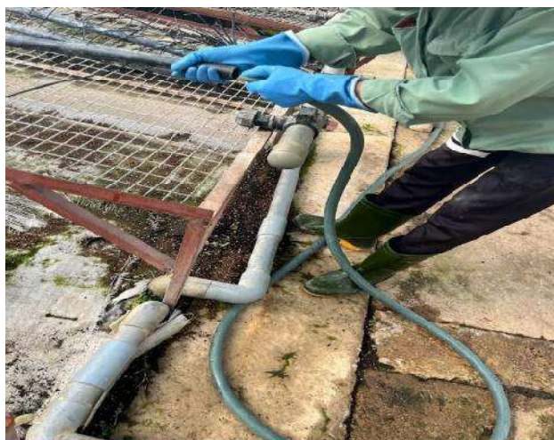
Hình 1.6.51. Vệ sinh hệ thống nhỏ giọt
