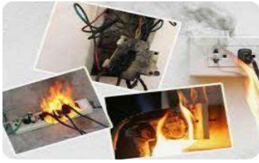
Chập cháy ổ điện
