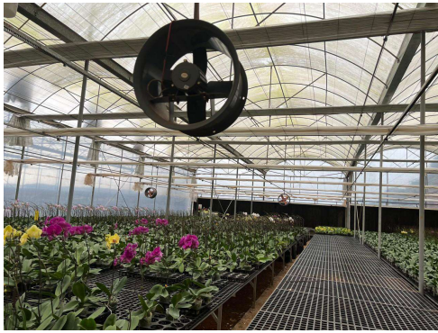
Hình 1.4.14. Hệ thống quạt thông gió
