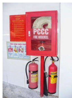
Hình 5.1.9. PCCC gắn tường
