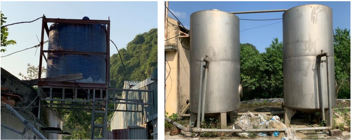
Hình 127. Hệ thống lọc nước của cơ sở chăn nuôi lợn
